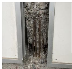
Till vänster exempel på skador mellan inglasade sektioner. Inglasningen har behövt monteras ned.
