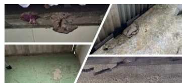
Exempel på balkongplattors skador
