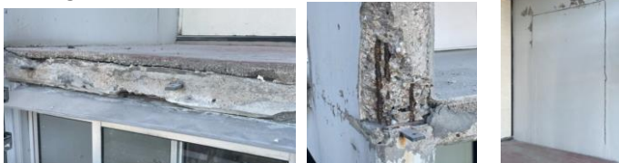
Exempel på skador i balkongplattans konstruktion, rostiga ytligt liggande armeringsjärn och synliga spår efter portar i sidoväggarna.
