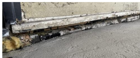
Till höger exempel på gränssnitt mellan balkongplatta och lägenhetens yttervägg. Kakel/klinker har behövt tas bort.
