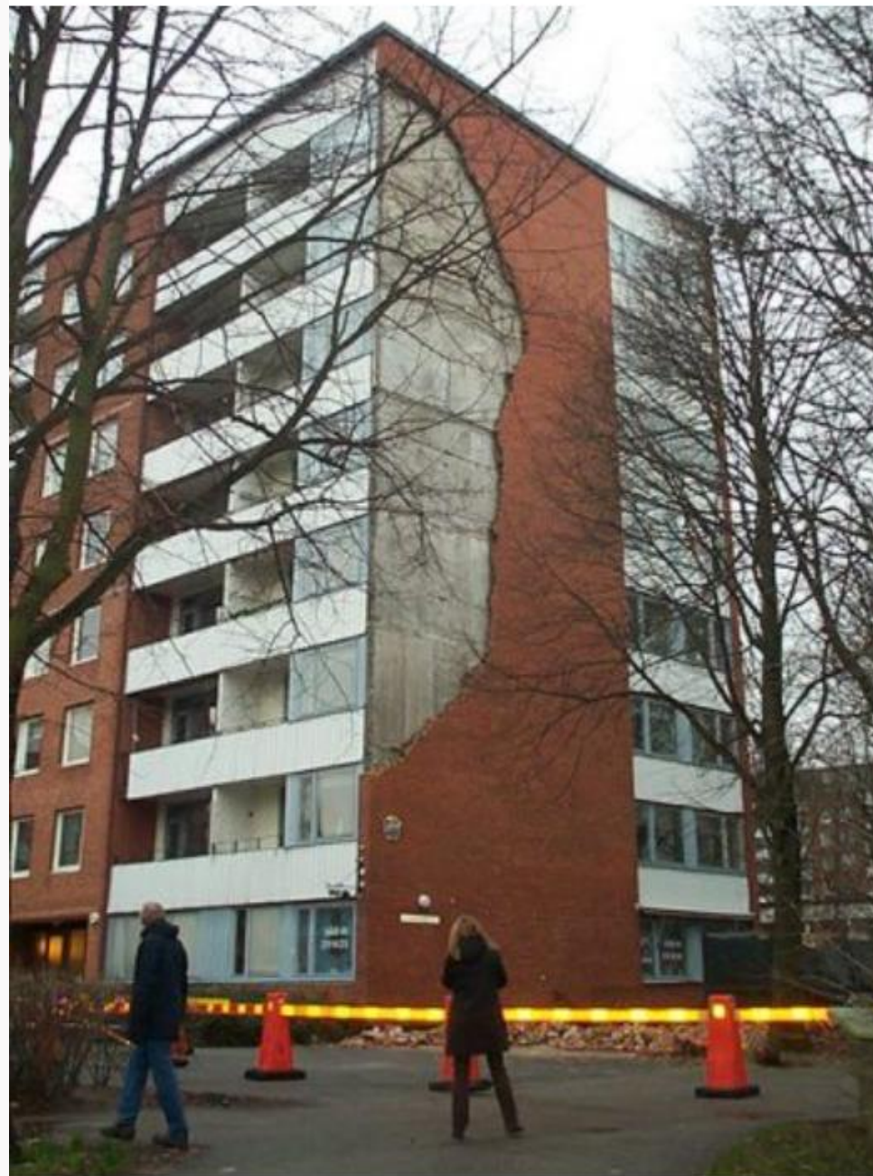
Tegelfasad som rasat från en fastighet i Lund efter stormen Gudrun.
